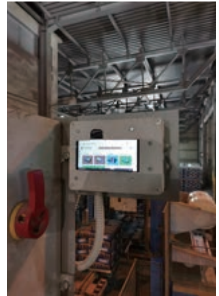
図3 カメラの画像データは、同じくラインの近くに配置されたこのエッジコンピュータに送信される。コンピュータは識別と解析を行い、欠陥のある袋をラインから取り除くために必要な是正策を講じる
