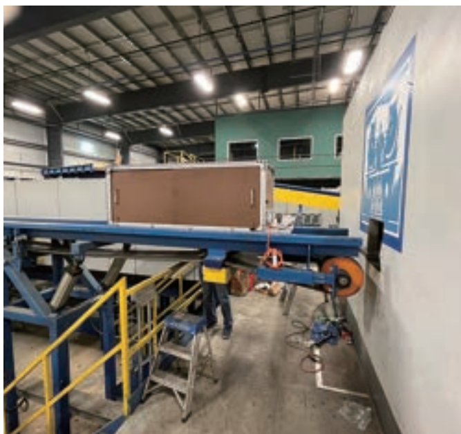
図2 Surface Finish Inspectorは、プレーナーミル内においてモルダーの近くに配置されている (写真提供: ポドキン社)
