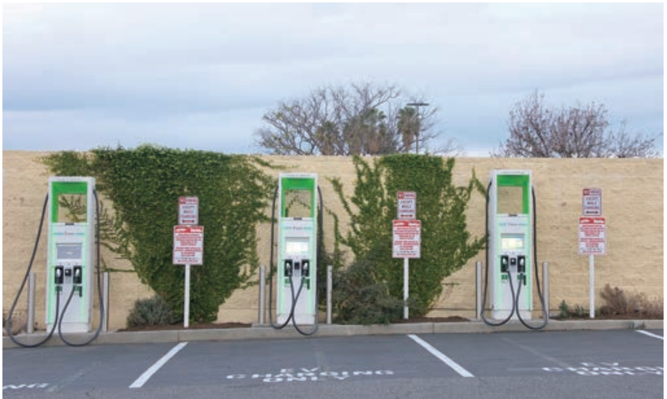
図1 電気自動車用の充電ステーションにより、建物のDC電力需要は増加することになる
