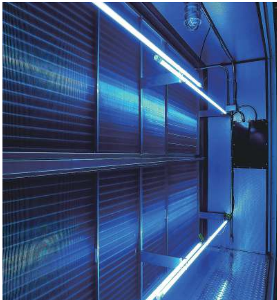
図1 HVAC空気処理装置内部のUV-C管によって、SARS-CoV-2を不活性化させつつ、HVACシステムの効率を高めて寿命を延長することができる。(写真提供:UVリソース社)
