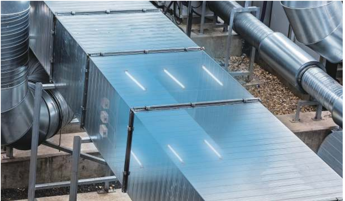
図3 ジョンソンコントロールズ社は、殺菌用のUV-CランプグリッドをHVACエアハンドリングユニット内部に実装している。(写真提供:ジョンソンコントロールズ社)
