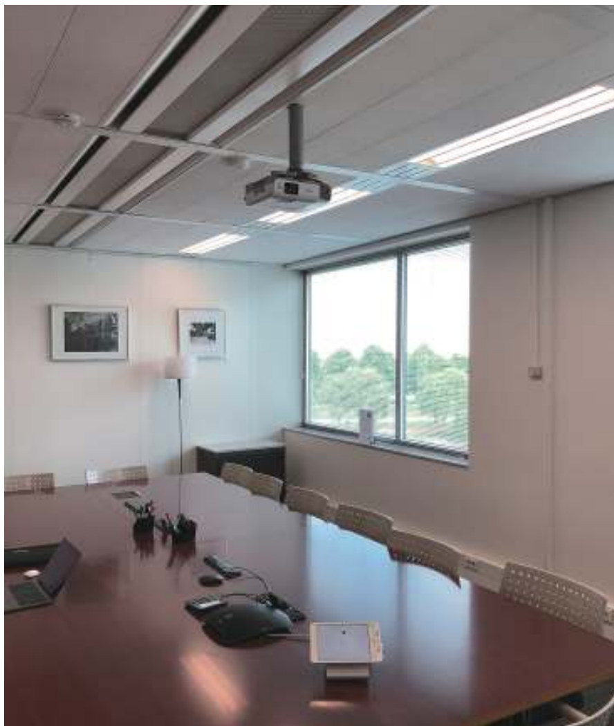
図4 CBRE社のスマートビル試験では、センサと通信チップが天井照明に内蔵されており、その電力は照明と同じ電源から供給されている。(写真提供:CBRE社)
