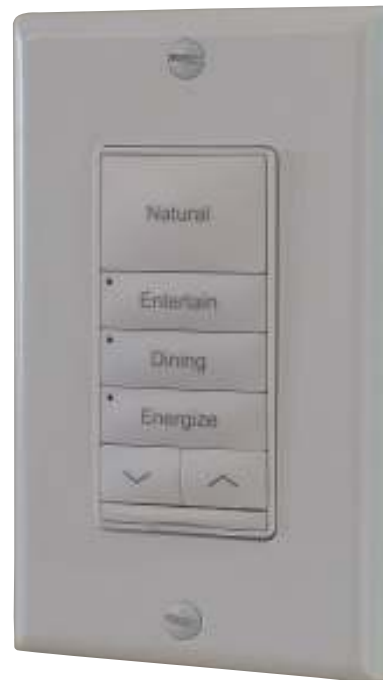
図1 ダイニングエリアの制御パネル。居室者はこれを使って簡単にシーンを変更できる。その一方で、1日のうちの時間や1年のうちの時期に応じて、光環境はプログラム制御によって自動的に設定することができる。
