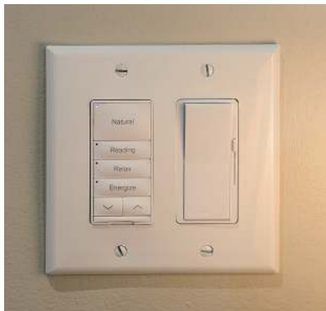
図3 リビングの制御パネルには、ケトラ社のソフトウェアを通して設定可能な標準的なシーンに加えて、白熱電球やハロゲンランプを制御できる既存の調光器が装備されている。
