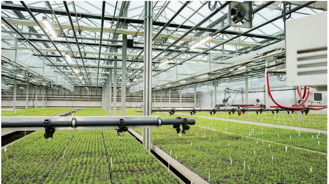
図3 ビニールハウスのように、泥などの汚れもある厳しい環境では、能動的な冷却システムが簡単に故障してしまう恐れがあり、それが照明システム全体の故障につながる。受動的な冷却システムならば、エネルギー効率が改善されるだけでなく、壊れたり詰まったりしやすい可動部品が不要である。
