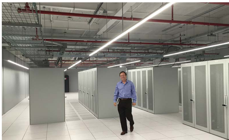
図5 データセンターにおいて、マルチチャンネルドライバによって給電され、天井梁にマグネットで取り付けられた直線形モジュール。
