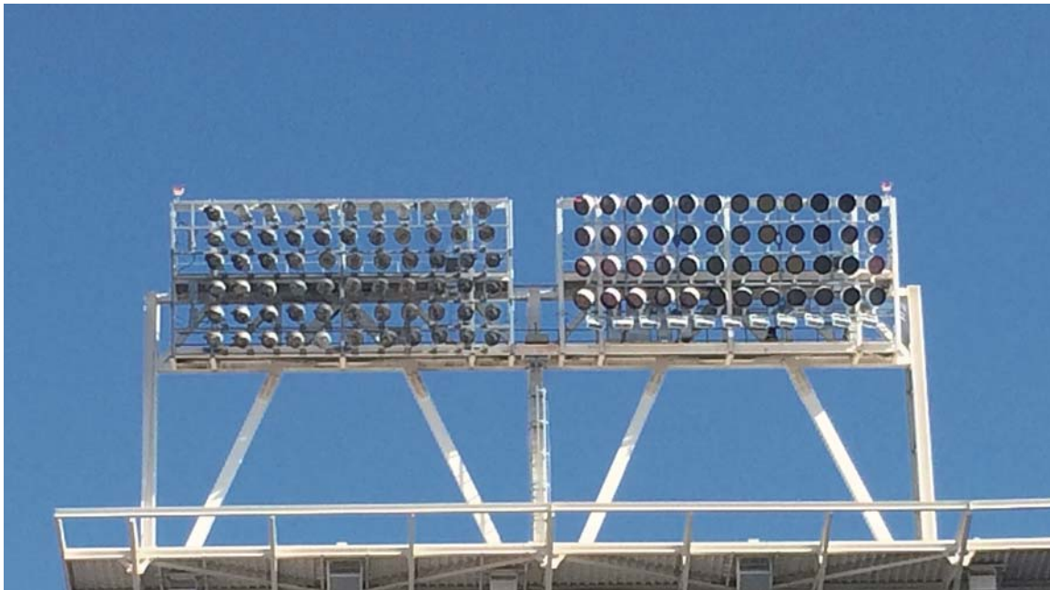
図5 ペトコパークにおいて、以前の照明が設置された左側のラックには照明器具が6列に並んでいるのに対し、右側のラックのSSLは4列しかない。(写真提供：サンディエゴ・パドレス)
