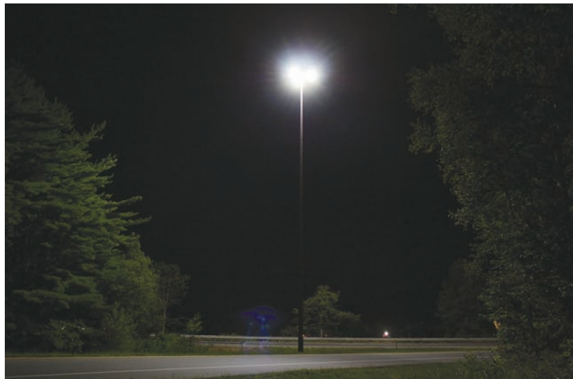
図3 米国メイン州ウォータービルにあるLEDベースのハイマスト照明ポール。
